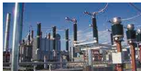
Япония: изолирующий трансформатор и силовой трансформатор для APR Energy
