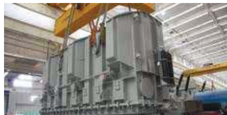
Пуэрто-Рико: трансформатор USA230kV 570MVA
