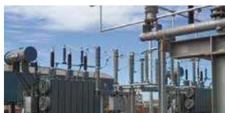
Австралия: трансформатор 132kV для ВНР
