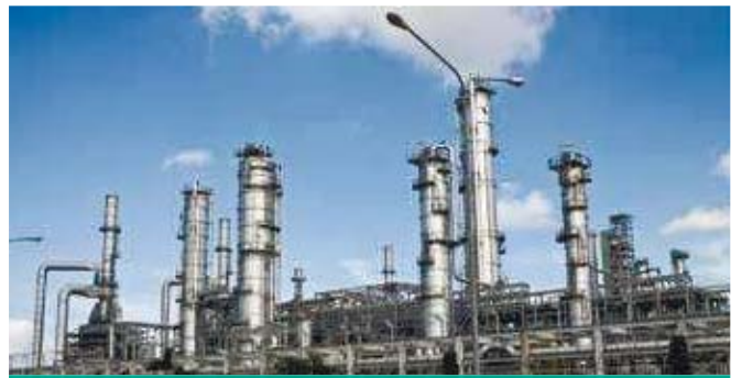
Ирак Salah - Электростанция Aldeen 2X630MW
