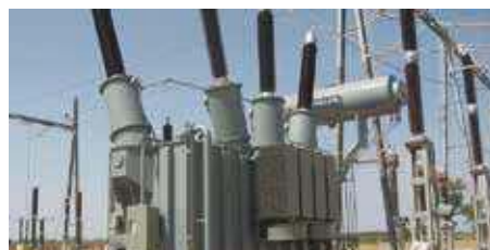
Буркина-Фасо: силовой трансформатор для Forclum
