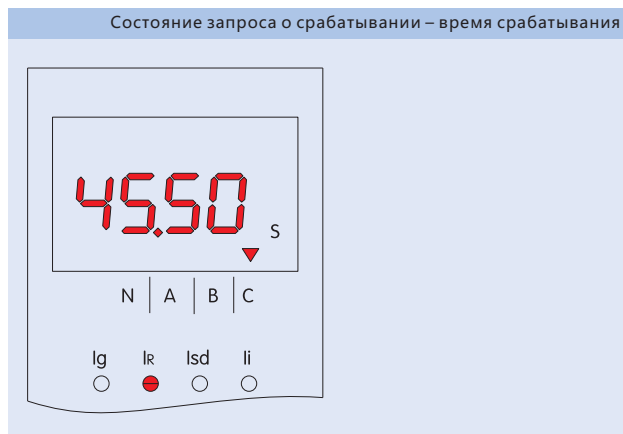
Состояние запроса о срабатывании – время срабатывания
