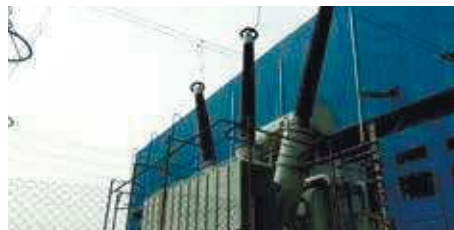
Индия: трансформатор 420kV 60MVA
